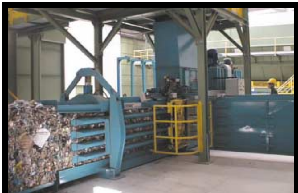
PRESSE AUTOMATICHE CONTINUE LEGATURA ORIZZONTALE
